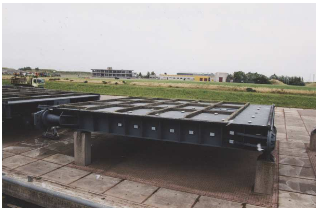
Une porte soudée des années 2000. Ecluse de Koopvaardeerschut. Canal de Nord-Holland, au Helder.
