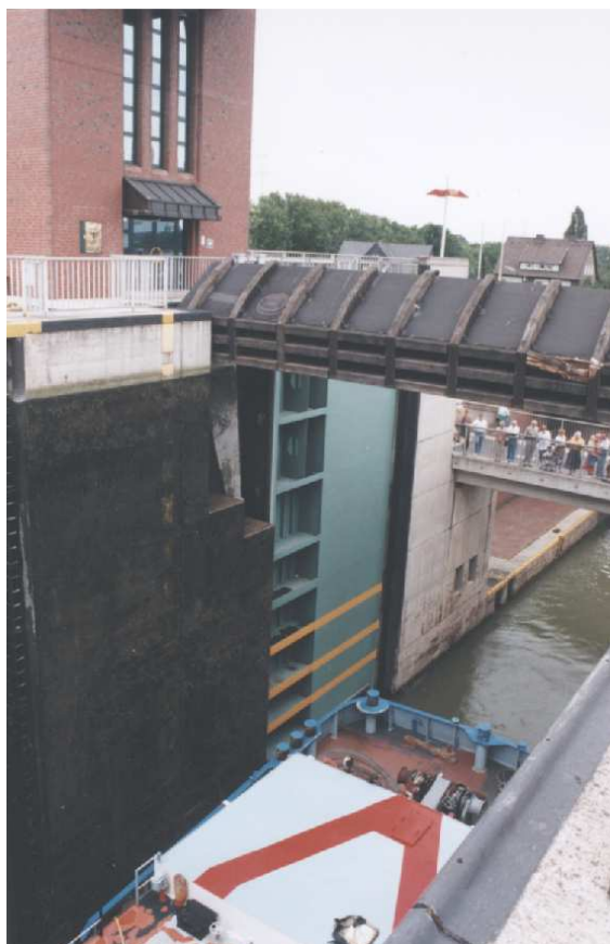
Henrichenburg, sur le canal Dortmund-Ems (D). Pare-choc (ébréché) protégeant les portes.
