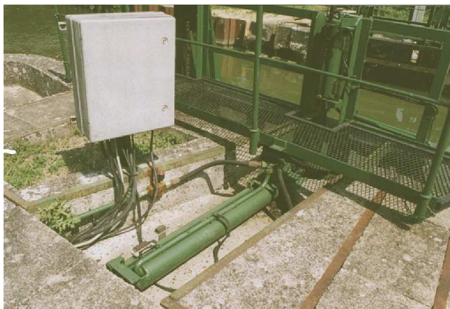
Commande de l'écluse de Travecy (F 02). Canal de la Sambre à l'Oise.
