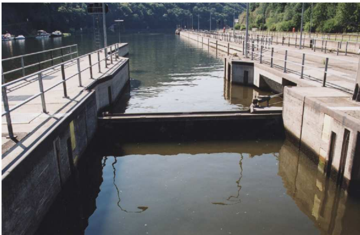
Un seul vantaill, à l'écluse de Mettlach, sur la Sarre (D).
