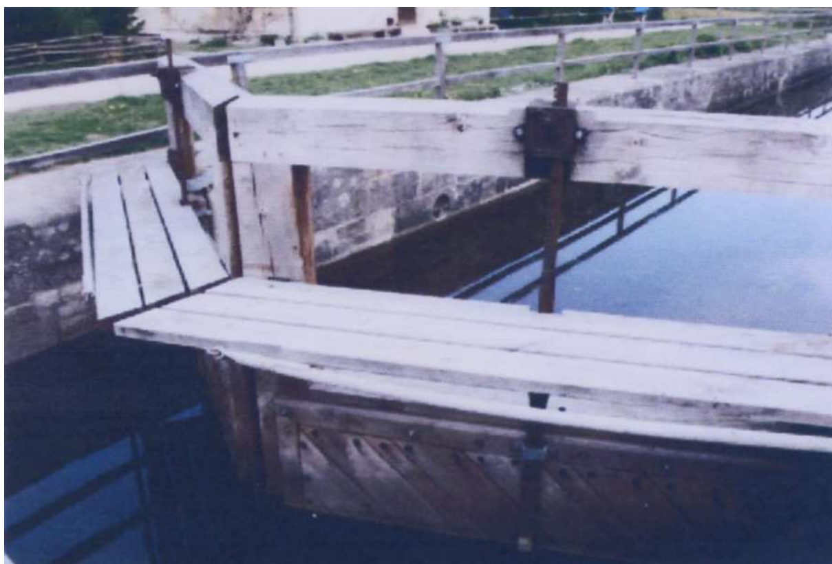
Passerelle en bois sur une porte neuve du Ludwig Kanal (D).
