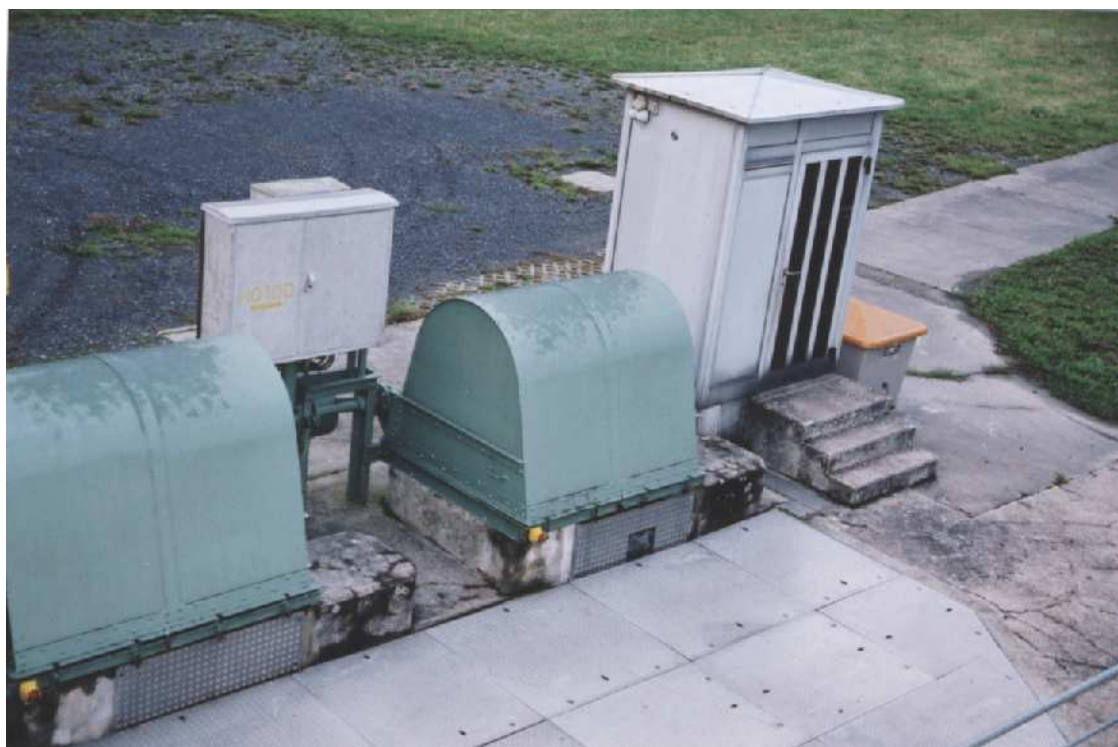
Dans les premiers temps de la mécanisation des portes, on se contentait de poser un moteur sur le bajoyer. Ecluse de Faystovo, Moskova (Rus).
