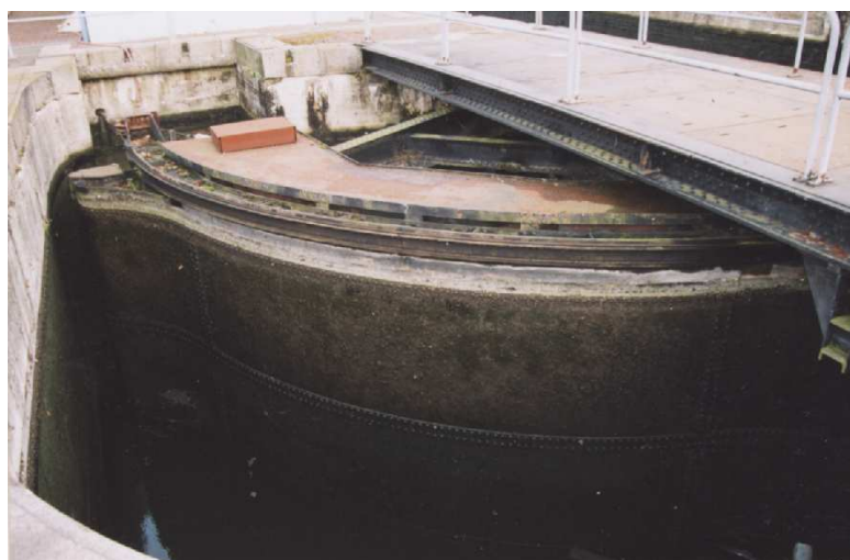
Ecluse du Don, sur la Deule (F 59) le tambour sous le quai tourne autour de son axe, en équilibre avec un vantail.
