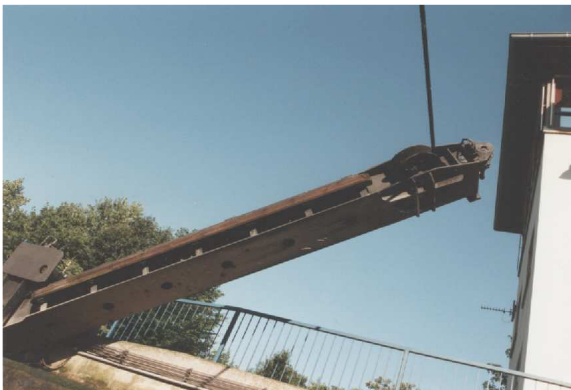
Ecluse de Peterhagen, sur la Weser (D). L'un des deux bras portant l'élingue qui protège les portes.
