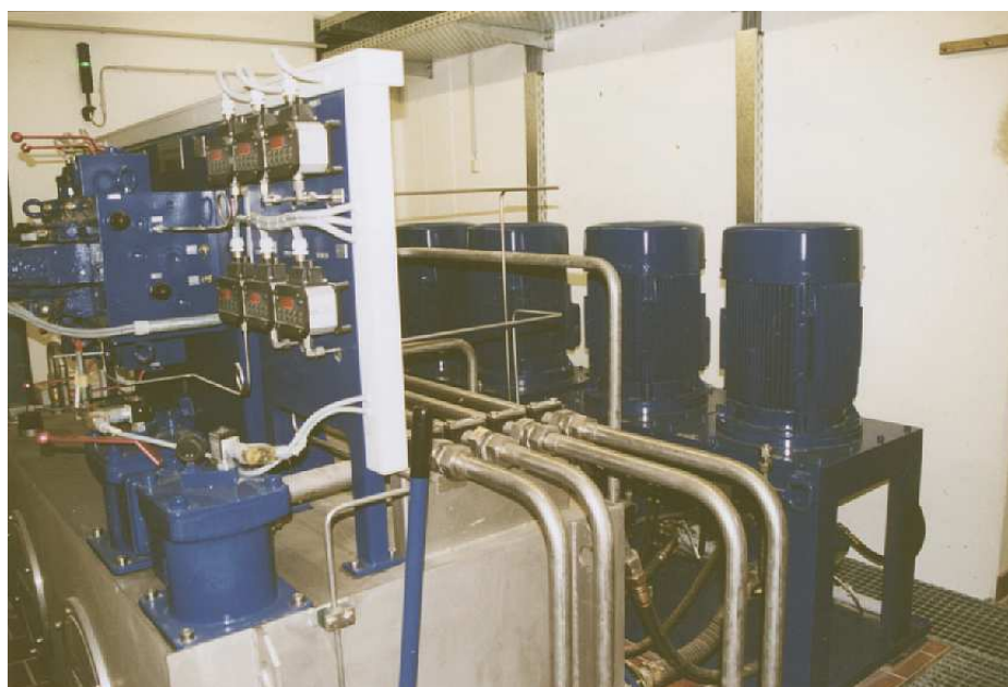
Aujourd'hui, les portes géantes sont commandées par une salle des moteurs. Ecluse de Rothensee Mittelland Kanal (D).
