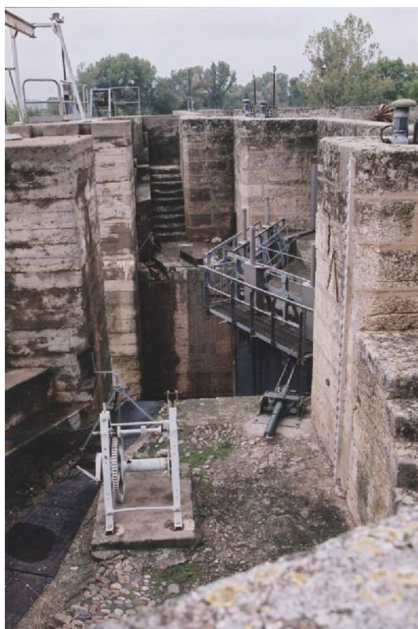
Treuil de l'écluse de Moussoulens. Canal de la Robine (F 11).
