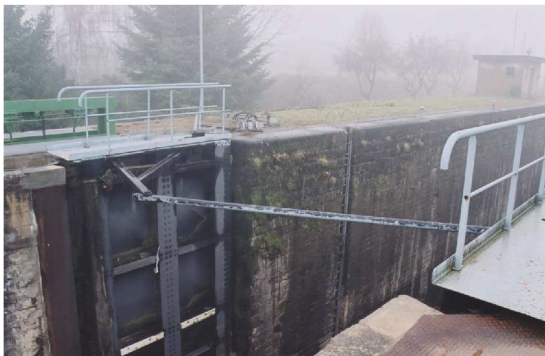
Ouverture – et fermeture – simultanée des deux vantaux : l'un entraîne l'autre, à l'écluse n°1 du versant Loire du canal de Charolais (F 71).
