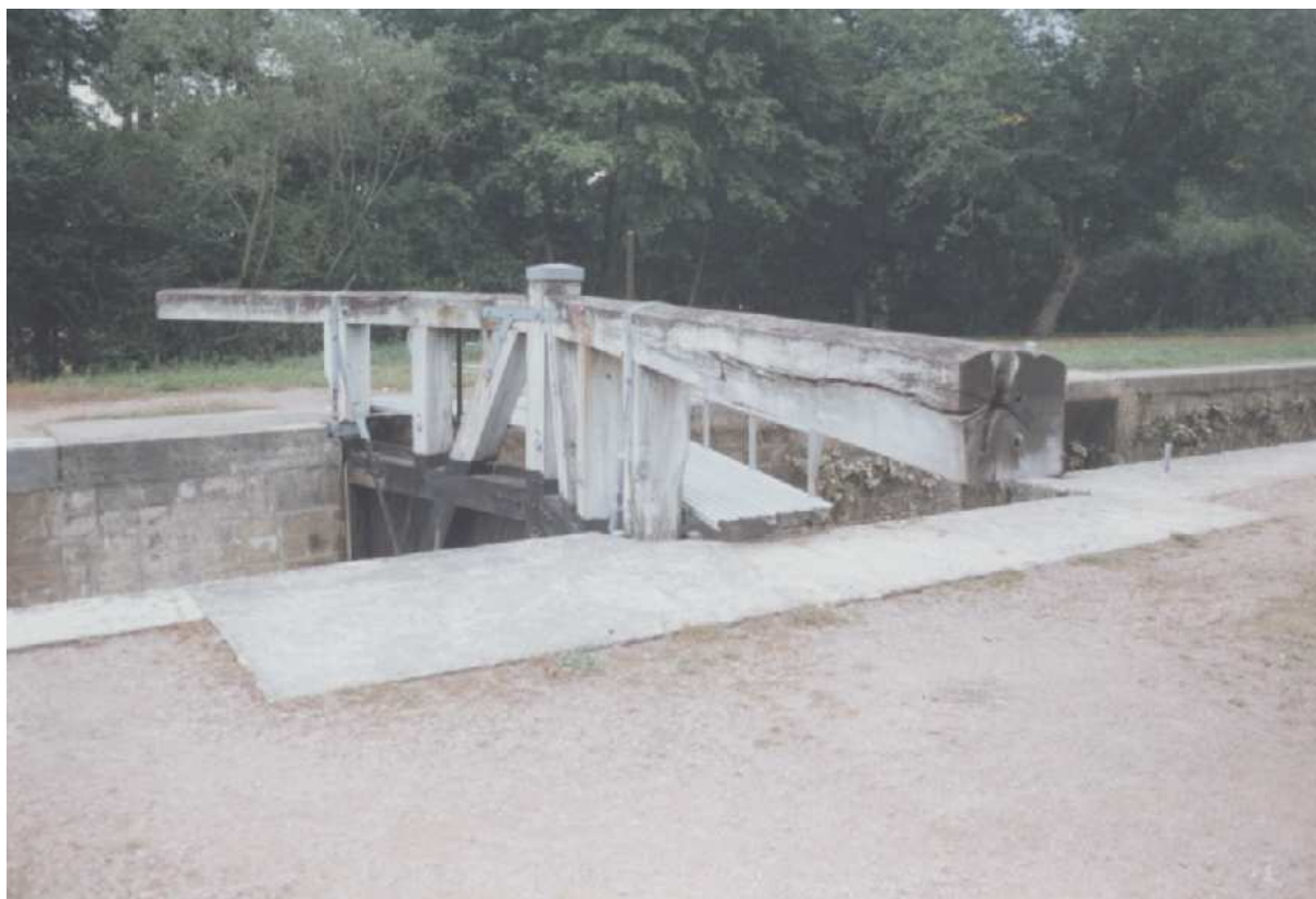
Balanciers de l'écluse du Pré Colas. Canal du Nivernais (F 58).
