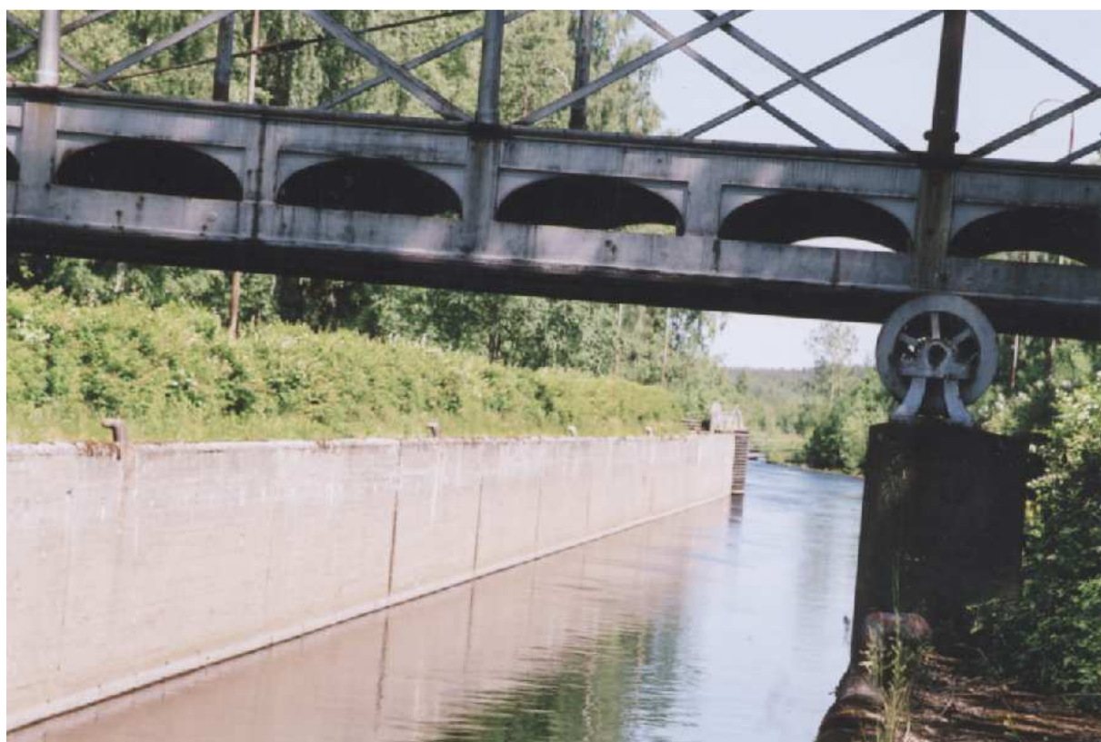
Canal d'Utra (Fin), Pont Erikson – 1856 – près Joensuu
