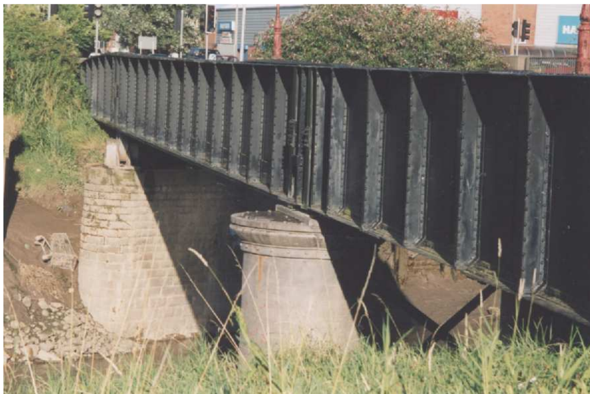
Pont roulant ferroviaire de Bridgewater (GB)
